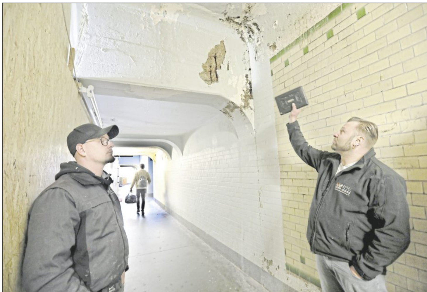
Projektleiter Andreas Wesel (rechts) und sein Kollege Nicolai Wiederhold zeigen den Ist-Zustand in der Bahnunterführung.
