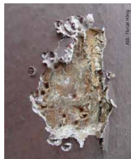
Abb. 9: Hier wurde vollflächig eine circa drei Millimeter dicke Spachtelung mit einem Acrylat aufgetragen, die die Austrocknung behindert.
