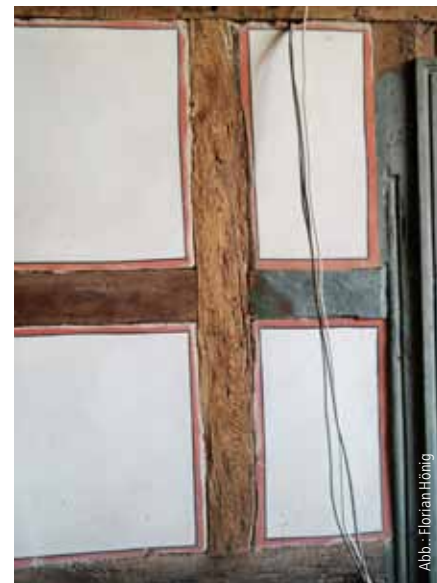
Abb. 7: Gerade die Gefacheränder müssen bei Strahlarbeiten geschützt werden, um sie nicht zu beschädigen.
