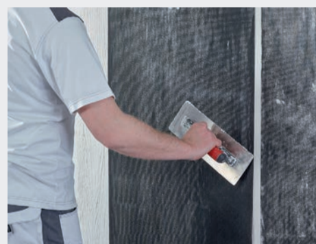
Die Flächenheizung wird eingespachtelt. Eine schwimmende Verlegung ist noch einfacher: Folie ausrollen und mit Tape auf der Trittschallunterlage fixieren.
